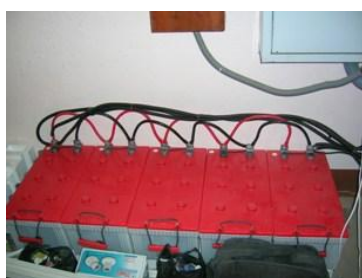
Ecco la batteria del nuovo generatore.
